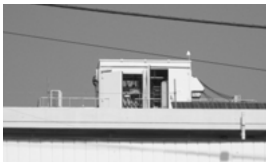
ビルの屋上に設置された基地局の例 内部はエアコンも完備されている。
